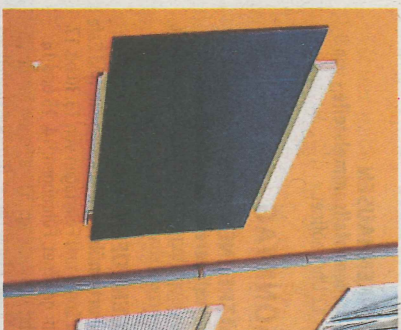
Das Fenster ist mit einer Holzplatte notdürftig repariert.
