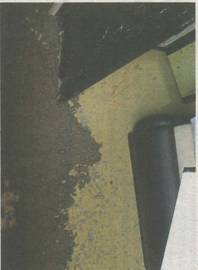
Der flüssige Beton landete im Schlafzimmer. Teppichboden und Möbel sind hin.
